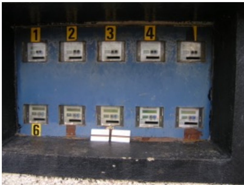
Above: meter boxes
